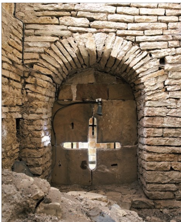
FIG. 17. TRAVÉE DROITE DU CHŒUR, vue, depuis les combles, de la face extérieure de la fenêtre sud. Cl. N. Blaya.
