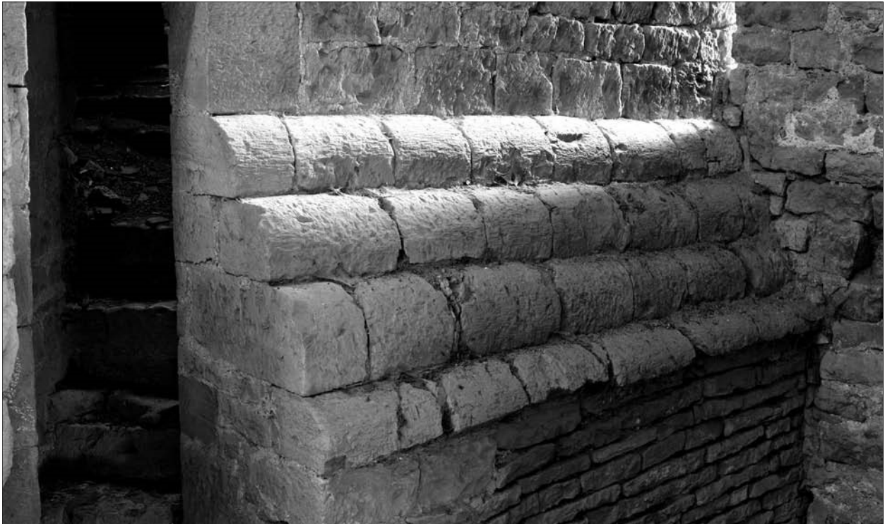
FIG. 24. COMBLES, ÉLEVATION SUD DE LA TRAVÉE DROITE DE CHŒUR, détail des ressauts de quart de rond épaulant la souche du clocher. Cl. N. Blaya.
